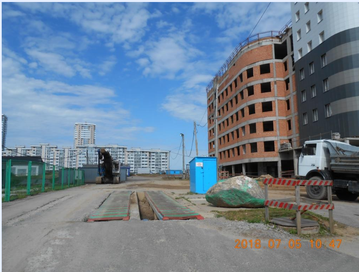
Пост мойки (очистки) колес
