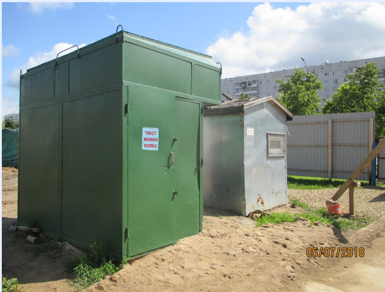
Пост мойки (очистки) колес
